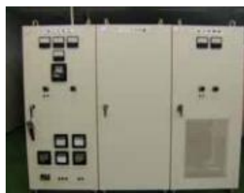
実習用受電設備
